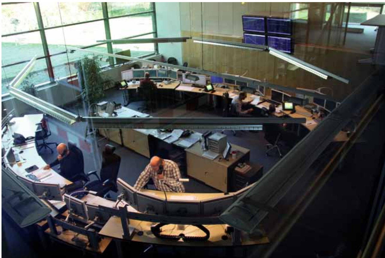
Bild 5. Netzleitwarte der Stromnetz Hamburg
