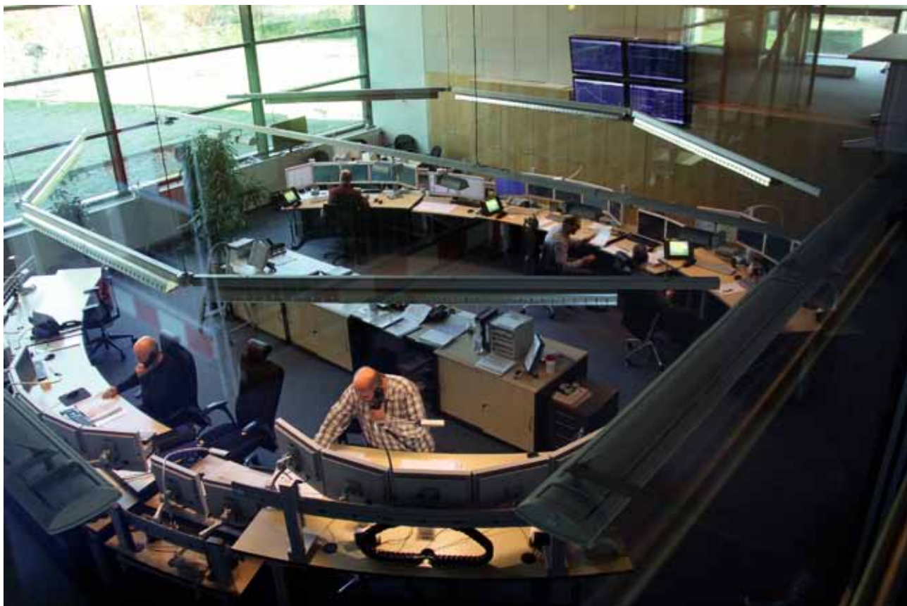
Bild 5. Netzleitwarte der Stromnetz Hamburg
